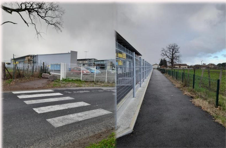
Merci à BRICOMARCHE qui a suivi les demandes de la mairie en réalisant un cheminement piéton entre la rue du Champ de course et leur parking, permettant de rejoindre Feurs de façon sécurisée.
